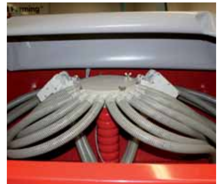
Im Tank liegender Verteilerkopf
